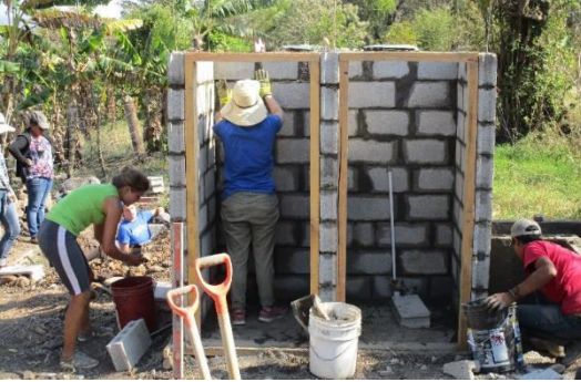
Dusche, Toilette und Waschbecken
